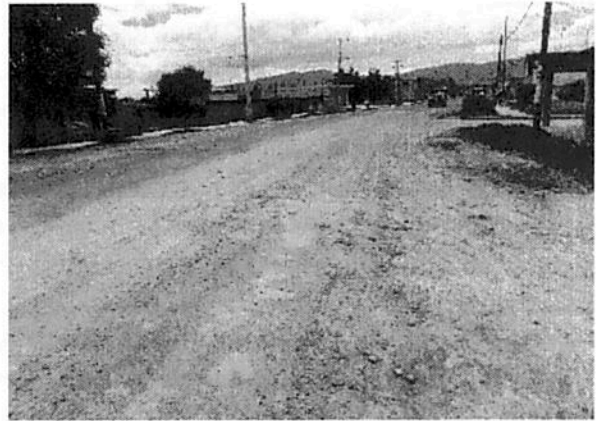
Tramo en terracería revestida sin banquetas ni guarniciones, son señalamiento adecuado Cadenamiento 1: sobre Calle Emiliano Zapata sentido a Ixtlahuaca-Atlacomulco Km 0+000 al km 0+505.37
