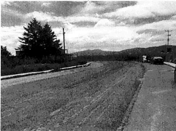
Carpeta asfáltica con desgaste, grietas, derrumbes, sin señalamiento horizontal ni vertical iii) Del km 2+400 al km 2+998.77 sentido a Concepción de los Baños (calle pavimento)
