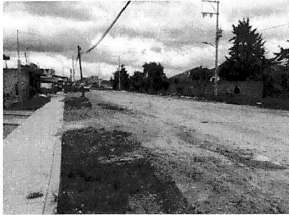
Tramos en terracería revestida Cadenamiento 1: sobre Calle Emiliano Zapata sentido a Ixtlahuaca-Atlacomulco Km 0+000 al km 0+505.37
